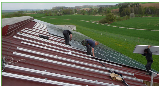
PV-Anlagen - immer noch sehr interessant
